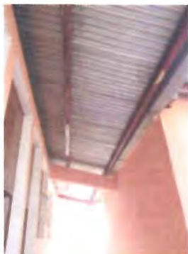
REPARACION SISTEMA ELECTRICO EN MAL ESTADO, LUCES QUEMADAS, BASES DAÑADAS
